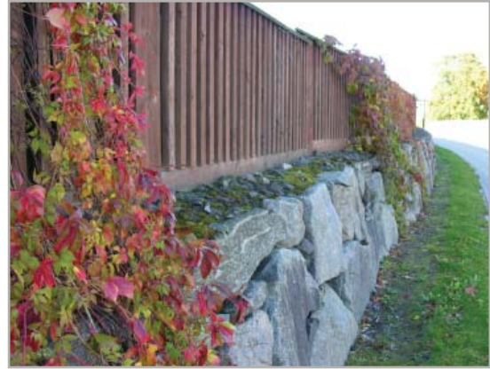
Støyskjerm i tre på mur
