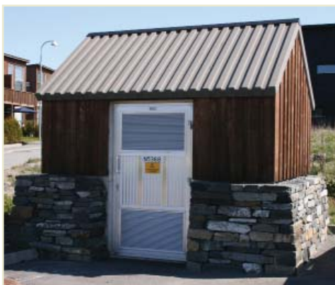
Trafo kan forblendes med naturstein
